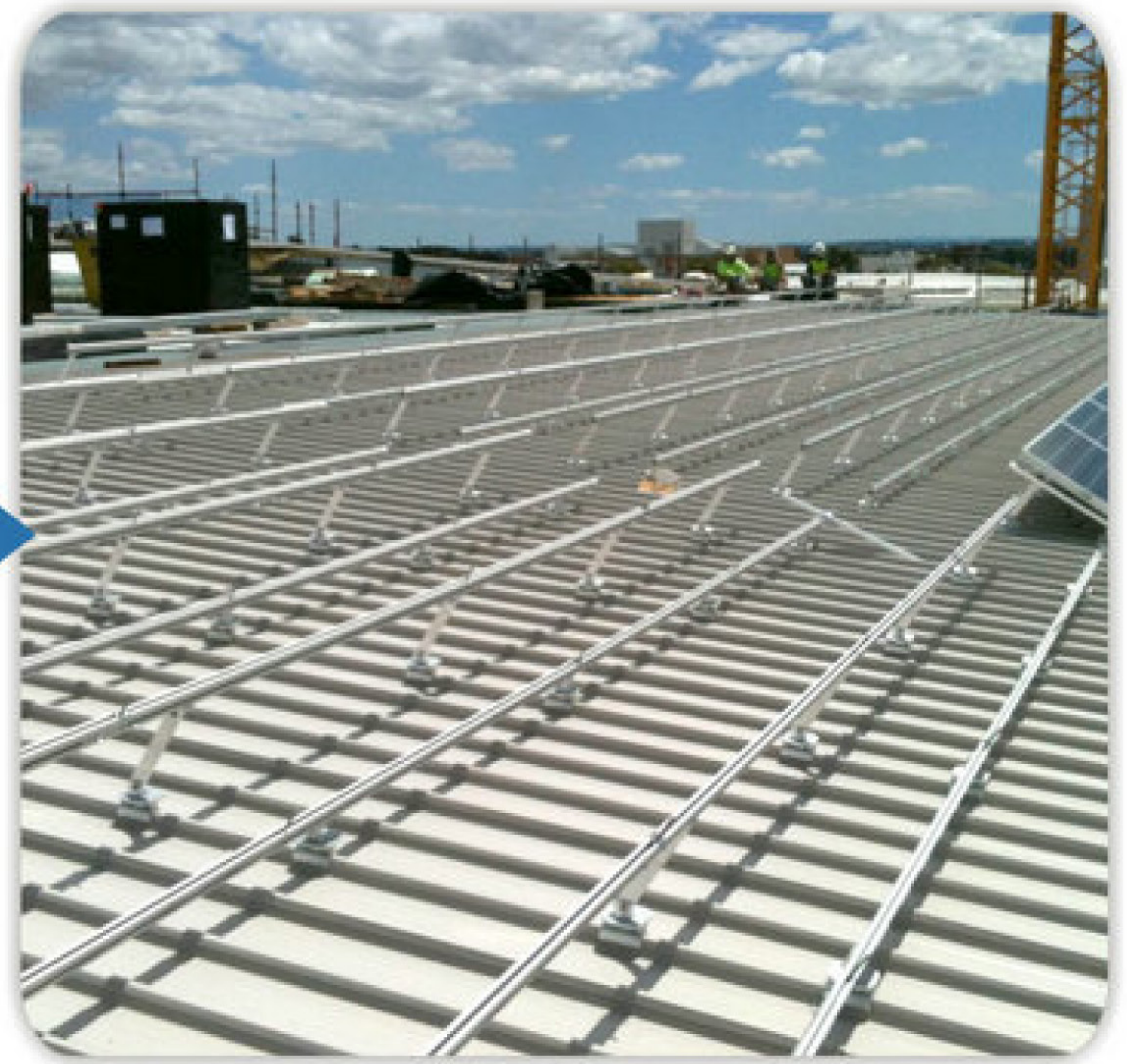
300kw kilplok roof
